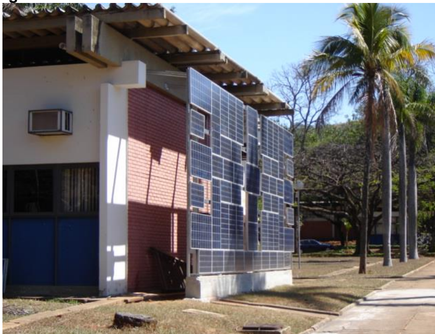
Figura 67 - Gerador fotovoltaico do Prédio 4 da UniverCemig
