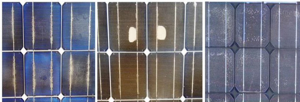
Figura 52 - Módulos degradados devido a delaminação do encapsulante
