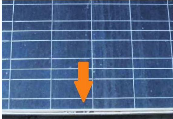
Figura 21 - Desprendimento em estrutura de enquadramento do módulo
